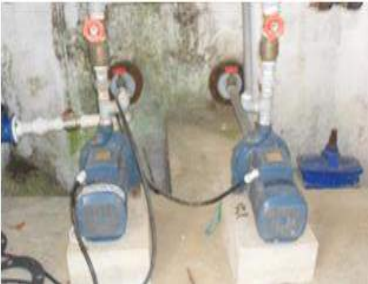
ILUSTRACIÓN 20 SISTEMA DE BOMBEO VILLAS DE 2000
